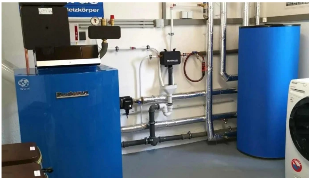
Bad heizung alte schlosserei gmbh innenansichten
