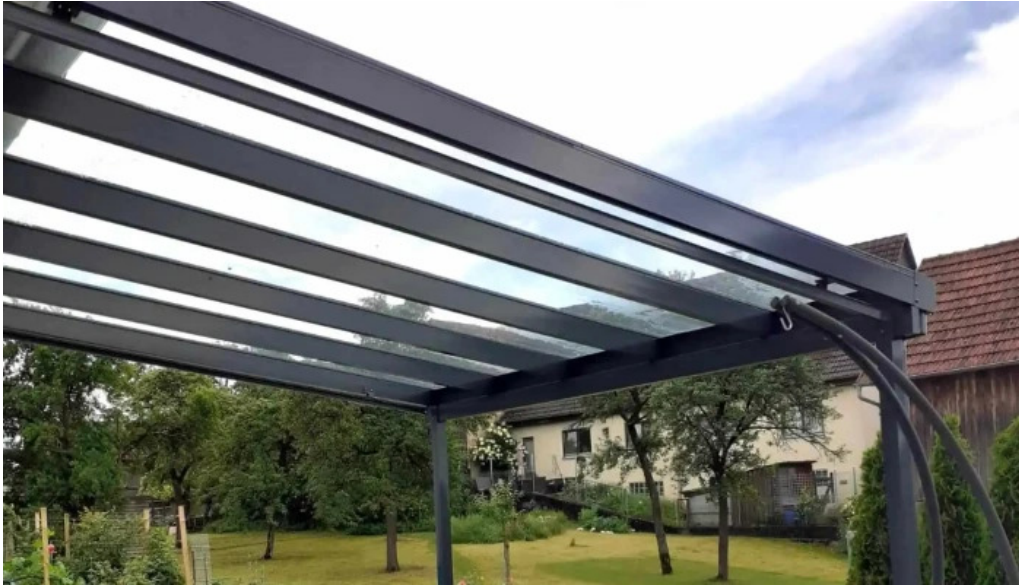
Metallbau rosenfelder gmbh haiterbach
