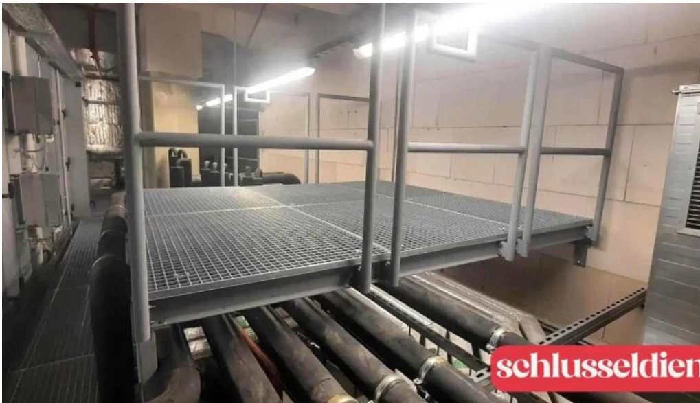
Plessing gmbh schlosserei und stahlbau innenansichten
